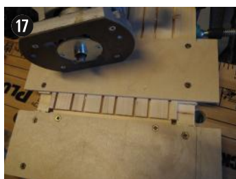
Feuillure pour montage en escargot usinée à la défonceuse avec montage d'usinage.
